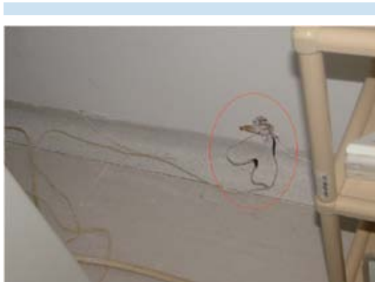
Figura 4. No conformidad en la inspección de la unidad de mamografía. Conexiones eléctricas inadecuadas (visita inicial).
