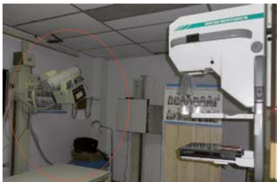
Figura 1. No conformidad en la inspección de la sala de adquisición de imágenes. La unidad de mamografía se encontraba en la misma sala de la unidad de rayos X convencional (visita inicial).
